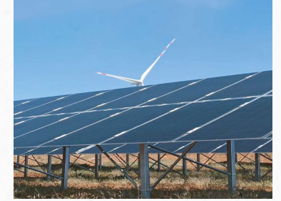
MALATYA ARAPGİR GÜNEŞ ENERJİ SANTRALİ
